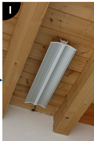
Collegamenti elettrici e controlli
